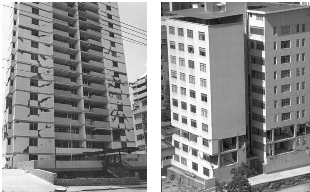
Figura IV.3 Ejemplo de distribución de daños en altura. Izquierda: edificio Castillete (FUNVISIS, 2005) con daño distribuido en toda su altura; Derecha: Edificio Coral (Steinbrugge, 1967) con daño concentrado en sólo dos entrespisos
