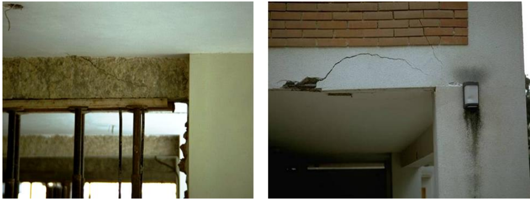
Figura III.16 Daños en vigas y losas (Steinbrugge, 1967)
