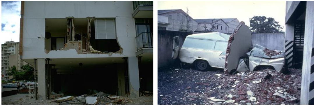
Figura III.14 Caída de paredes enteras hacia áreas exteriores del edificio Izq. (Steinbrugge, 1967). Der. (Milek, 1967)
