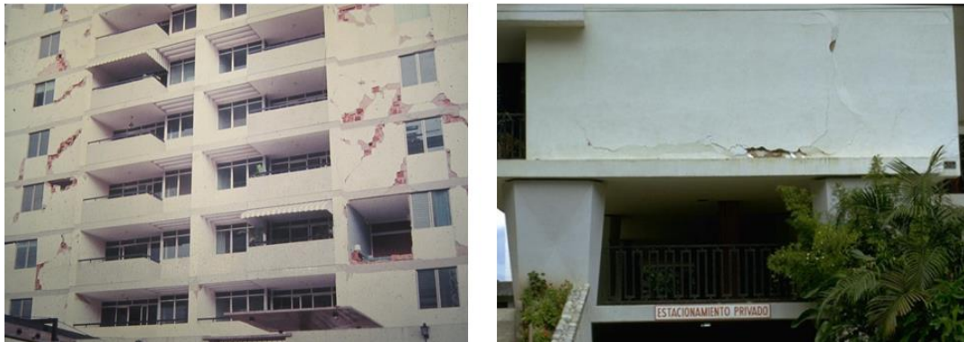
Figura III.13 Daño típico en paredes. Izquierda (Fintel et al., 1967): grietas diagonales y en “x”. Derecha (Steinbrugge, 1967): grietas perimetrales en el contacto con el marco
