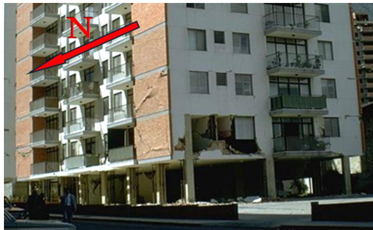
Figura IV.5 Edificio San Bosco (adaptado de Steinbrugge, 1967) Ejemplo de daños en paredes que indican una oscilación del edificio en dirección norte-sur
