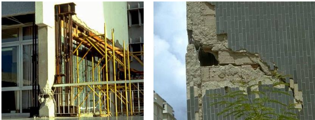
Figura III.15 Daños en columnas. Izq.(Bertero, 1967). Der. (Steinbrugge, 1967)
