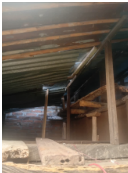
(b) Cubierta con entramado y arriostramiento insuficiente.
