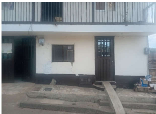
(a) Daños y agrietamientos en fachada de la vivienda.
