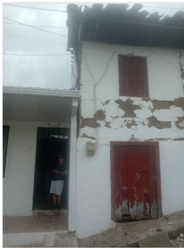
(b) Vista frontal de la estructura colindante. Se evidencia el estado de afectación.
