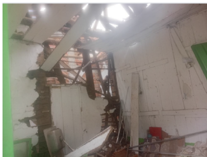
(b) Vista interior con colapso de muros divisorios y elementos de la cubierta.
