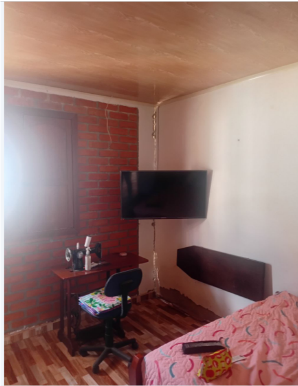
(a) Vista interior de la estructura afectada. Se evidencian ruptura en muro divisorio.
