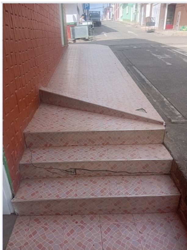
(b) Vista exterior de la estructura afectada. Se evidencia asentamiento diferencial del suelo.
