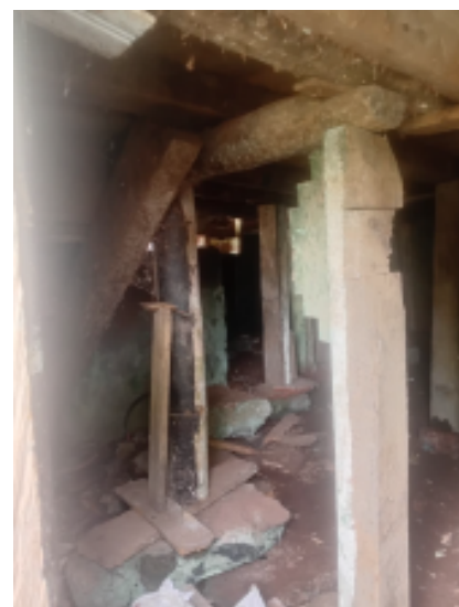
(c) Columnas de madera simplemente apoyadas sobre fragmentos de ladrillo suelto, sin cimentación ni anclaje.
