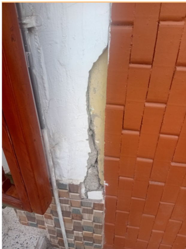
(a) Vista exterior de la estructura afectada. Se evidencian ruptura en muro divisorio.
