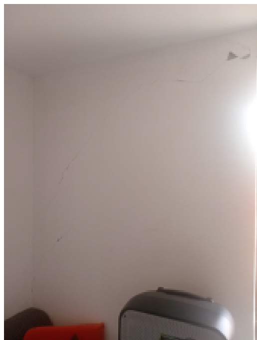
(b) Agrietamiento en elemento portante asociado a un posible asentamiento.
