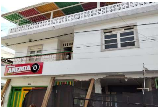
(a) Vista exterior de la estructura afectada. Se evidencian apuntalamientos ineficientes.
