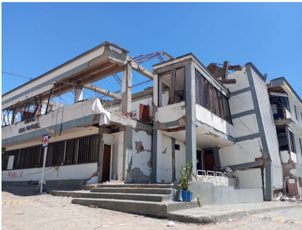
Figura 6. Vista exterior del Hospital San Rafael. Se observa el colapso parcial de gran parte de la cubierta del segundo nivel.
