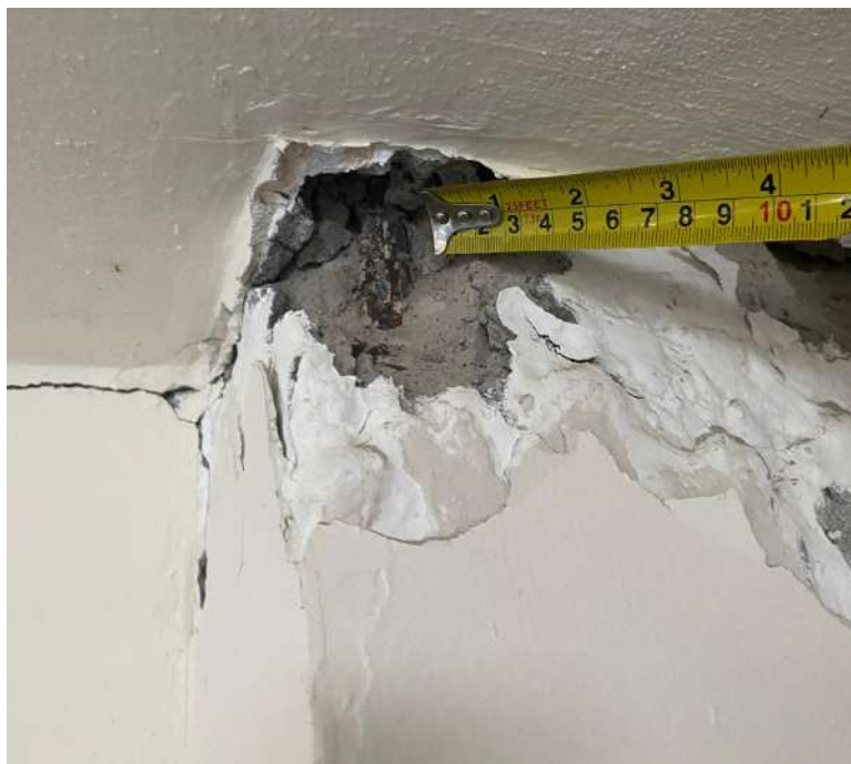
Figura 4. Desprendimiento del concreto de confinamiento en columnas del primer nivel.
