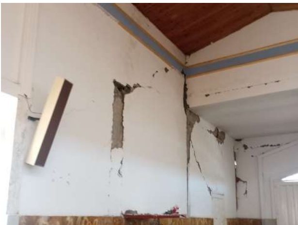
(a) Falla estructural en columna.
