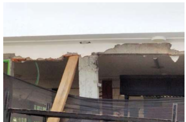
(b) Detalle del agrietamiento y exposición del acero (varilla lisa) de la columna inferior.
