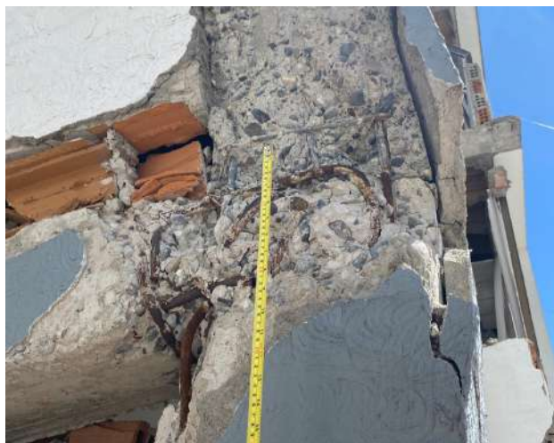
(a) Falla estructural en nudo viga-columna.
