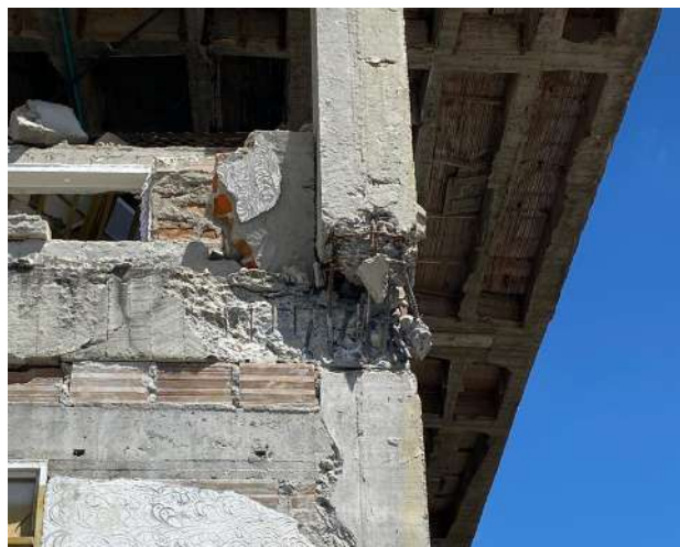
(b) Falla estructural sobre columna periférica.
