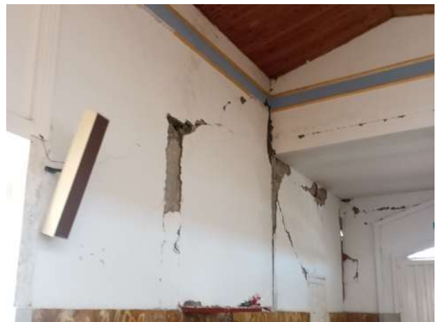
(b) Fallas de cortante en muros de mampostería.
