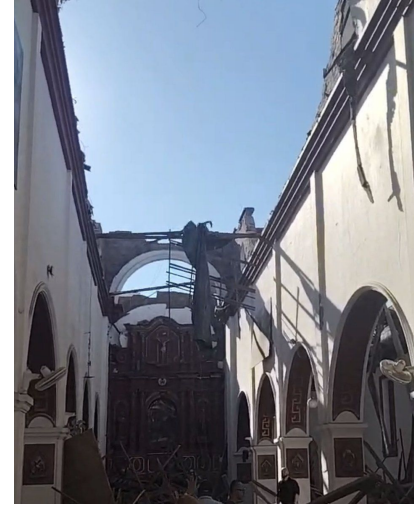
Roof collapse of the Basílica Menor de Nuestra Señora de la Pobreza in Cartago, Valle del Cauca, Colombia (Catholic Don, via X)[15]
